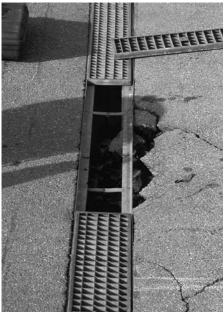
Schadstelle an Entwässerungsrinne infolge ungenügender Unterfüllung der Rinne.
