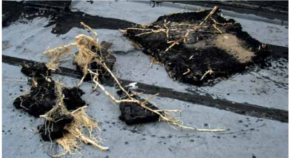
Wurzeln sind aggressiv – und haben schon mancher nicht wurzelfester Abdichtung ein vorzeitiges Ende bereitet – deshalb ist bei Flachdächern ein regelmässiger Unterhalt angezeigt.
