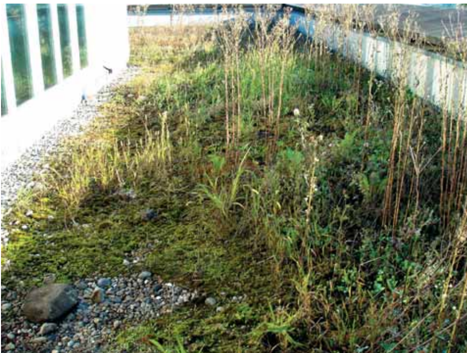
Kein Wildwuchs auf dem Flachdach – der Unterhalt von Flachdachbelägen ist zwingend.
