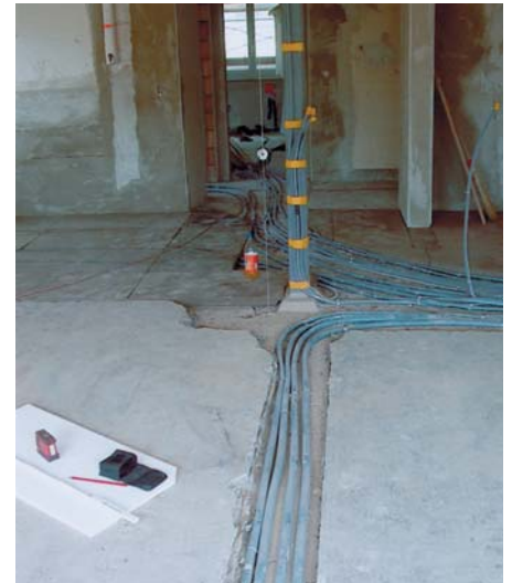
Bild 1 zu Beispiel 3: Zustand vor der Bearbeitung: Die neuen Heiz- und Stromleitungen sind in den alten Unterlagsböden eingelassen.
