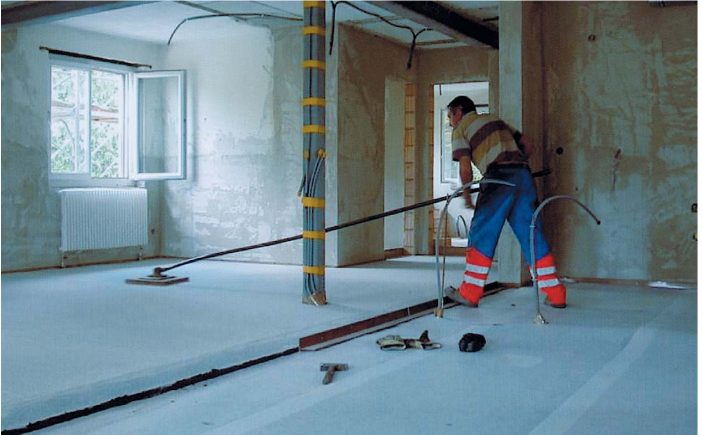
Bild 7 zu Beispiel 3: Abreiben des Gussasphalts mit Quarzsand als Haftbrücke für Nutzbeläge (Parkett, Plättli, Teppich usw.).
