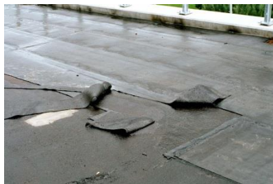
Abbildung 1: PBD-Abdichtung mit sehr schwachem Verbund. Direkt nach dem Aufflämmen war der Verbund gut, am nächsten Tag jedoch völlig ungenügend.
