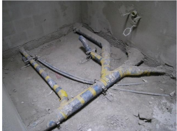
Construction neuve ou transformation avec beaucoup d'installations.
