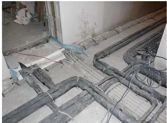
Construction neuve ou transformation avec divers tuyaux
